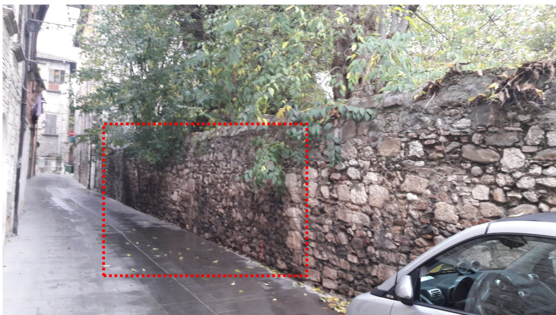
PdV 02 – foto da via Alamanni verso palazzo Colucci: in evidenza le ampie macchie di umidità che interessano il muro
