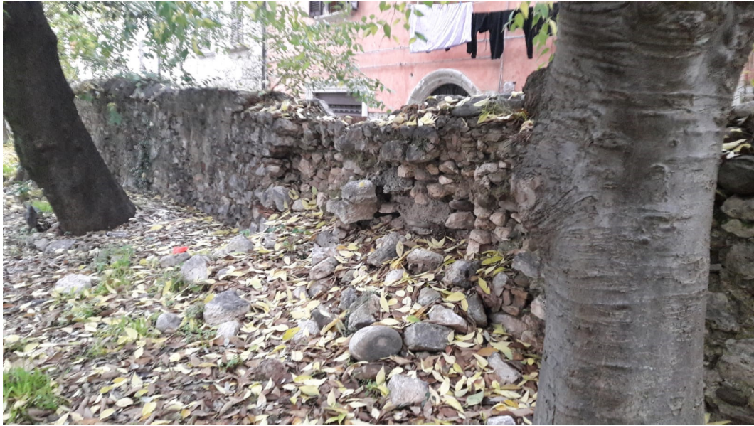
PdV 03 – foto dall'interno del giardino Colucci: in evidenza la parte del muro interessata dal crollo e le alberature presenti
