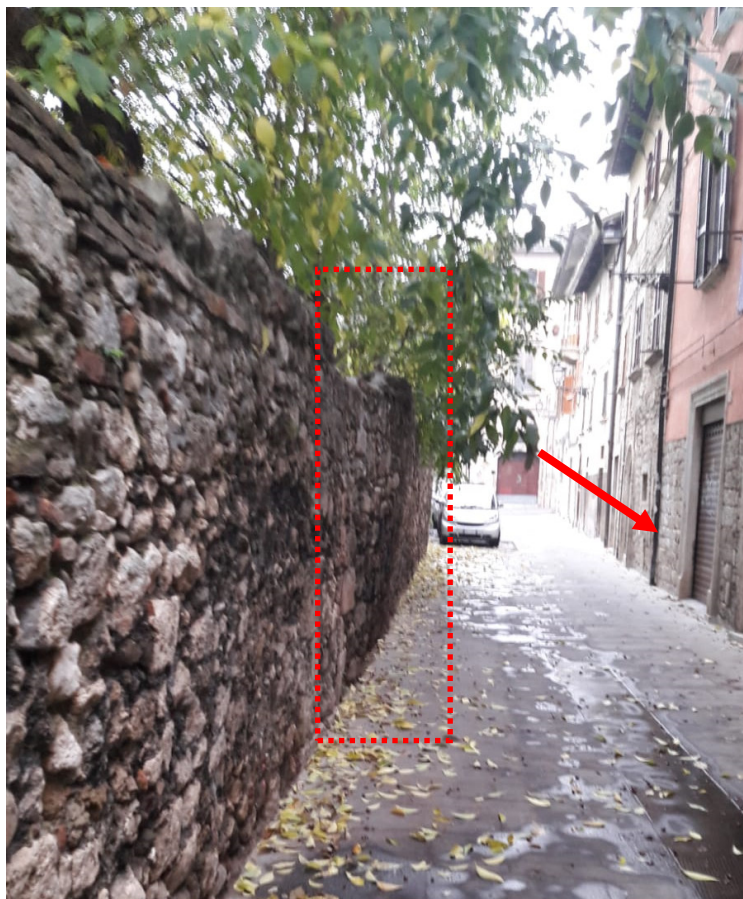
PdV 01 – in evidenza la zona del muro con la parte fuori piombo. A dx, sulle facciate degli edifici prospicienti si intravedono gli ingressi
