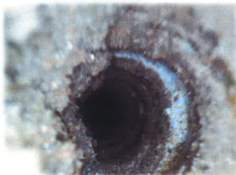
Particolare endoscopia n. 6 Muratura in pietrame disordinata con caratteristiche omogenee per tutta la profondità indagata
