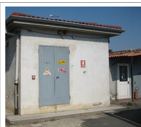
Cabina Elettrica (J)
