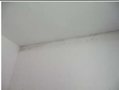
13. Tracce d'umidità nelle pareti dell'alloggio di servizio
