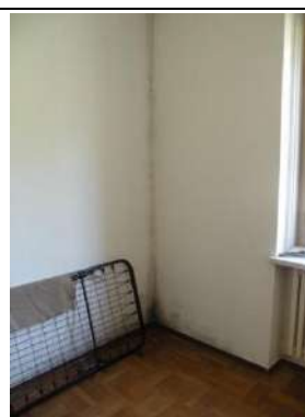
16. Umidità murature locale casermaggio
