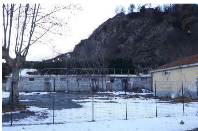
TO0714005 – Fabbricato tetto crollato
