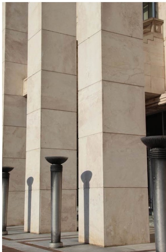
Fig. 13: Pilastrini con antistante sistema di illuminazione
