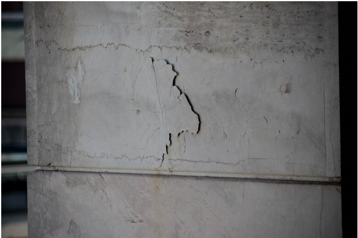
Fig. 31: Dettaglio di una lastra interessata da una porzione in fase di distacco
