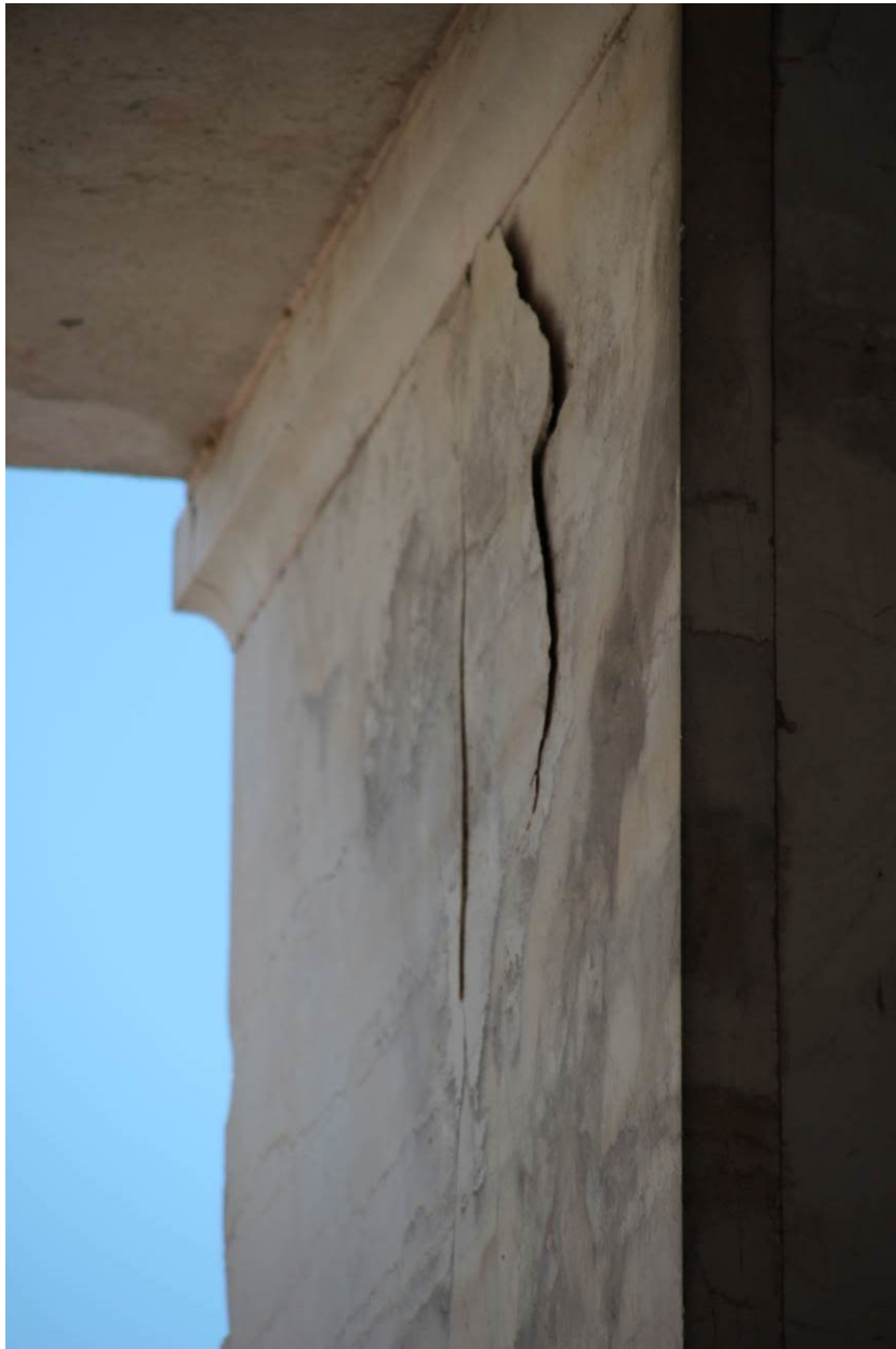
Fig. 33: Dettaglio di una lastra interessata da una porzione in fase di distacco
