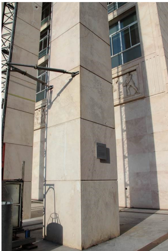
Fig. 12: Parte inferiore del pilastro angolare
