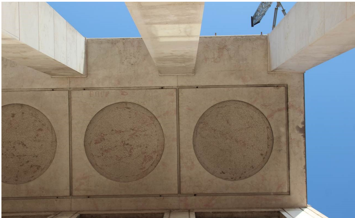
Fig. 20: Vista delle ultime due campate dell'intradosso del portico con finitura a marmorino
