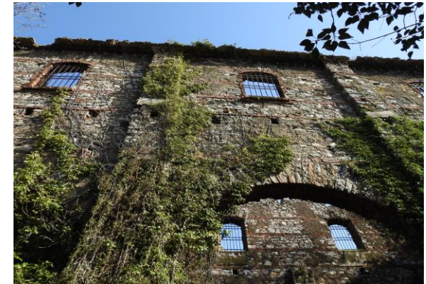
2021, fotogramma del fabbricato danneggiato
