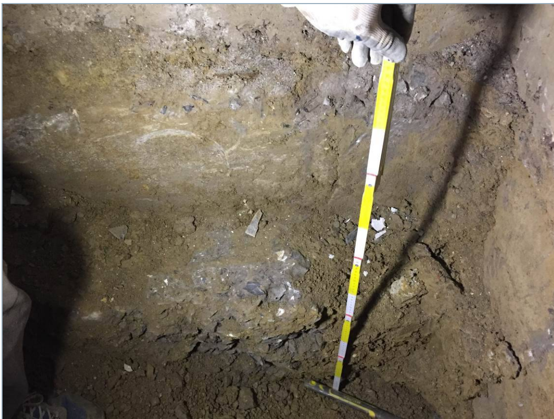
Foto dello scavo 3; visibile l'allargamento della fondazione di 25 cm a quota -80cm dal piano di calpestio. Il manico dell'utensile è la quota di intradosso: -130 cm.
