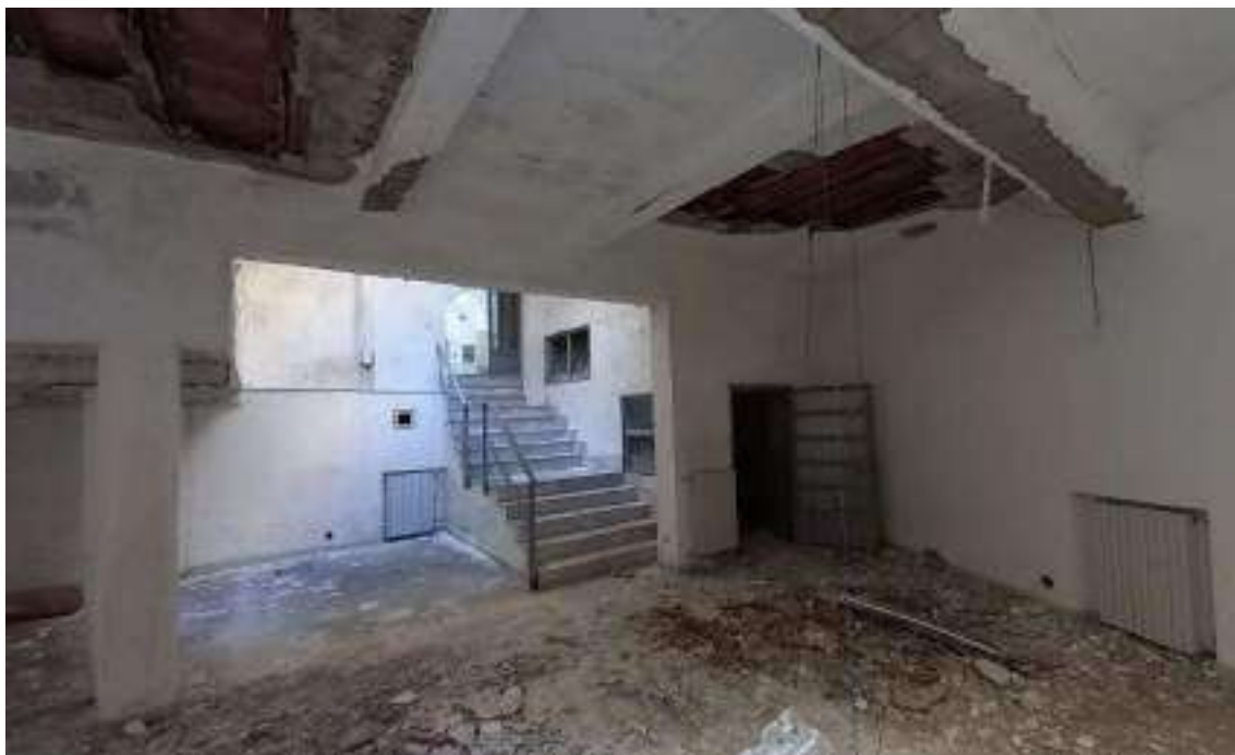
Foto 152 – area da mettere in sicurezza
