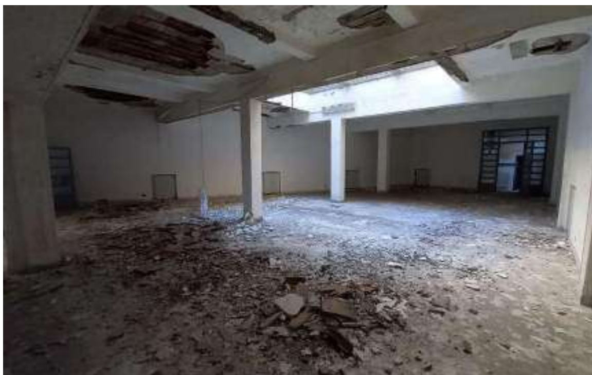
Foto 153 – area da mettere in sicurezza
