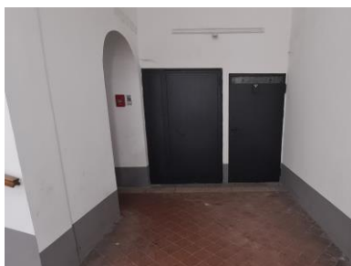
INTERVENTI DA EFFETTUARE SU IMMOBILE NAD0067
