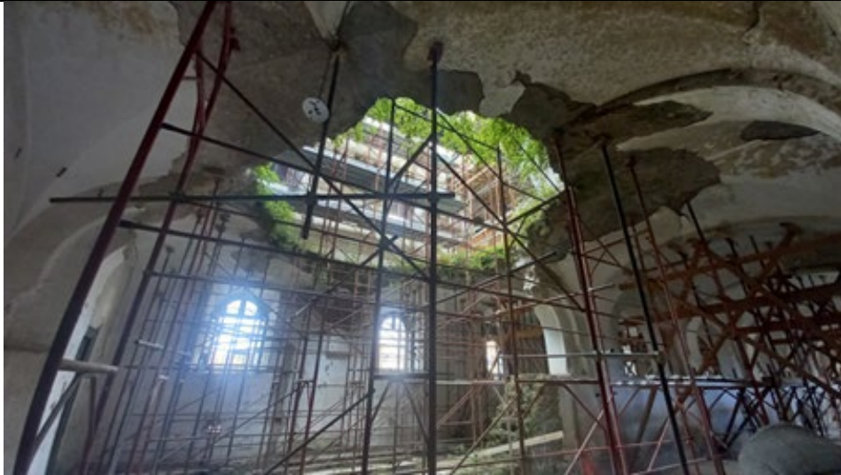
Figura 15 Particolare solaio crollato
