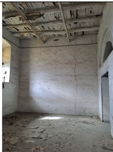
Figura 20: particolare solaio in legno e lesioni murature
