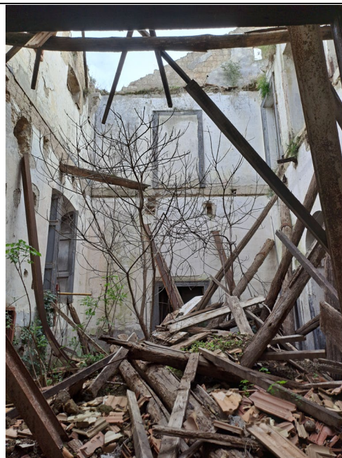
Figura 18: dettaglio crolli solai
