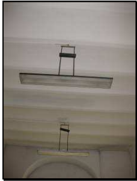
Foto 58 - Zona 6 – Particolare plafoniere
