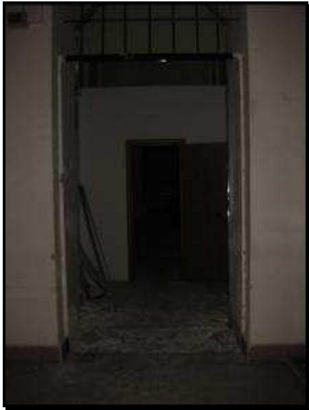
Foto 7 – Zona 1 - Particolare infisso
