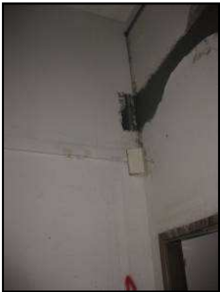
Foto 17 – Disimpegno 1 – Particolare ripristini da eseguire
