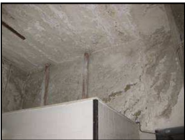
Foto 23 - Gruppo WC – Particolare colonne montanti scarico e soffitto ammalorato
