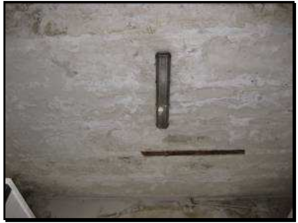
Foto 26 - Gruppo WC – Particolare soffitto ammalorato
