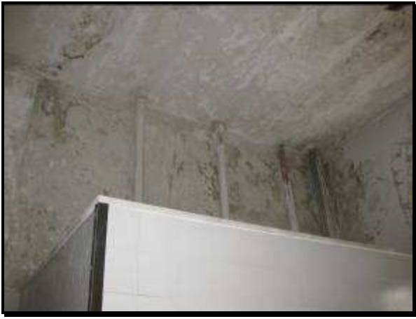
Foto 25 – Gruppo WC – Particolare colonne montanti scarico e soffitto ammalorato
