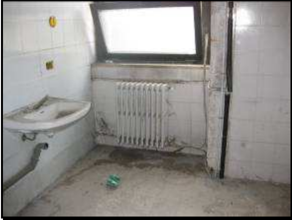
Foto 31 - Gruppo WC – Particolare radiatore
