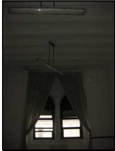
Foto 14 – Zona 3 - Particolare plafoniere
