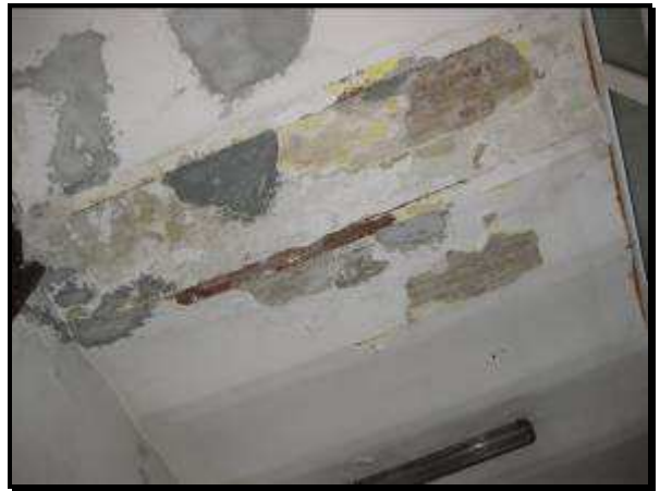
Foto 28 – Gruppo WC - Particolare soffitto ammalorato
