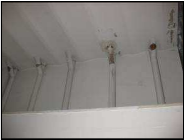
Foto 21 - Gruppo WC – Particolare colonne montanti scarico
