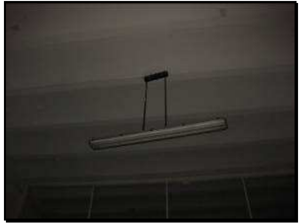
Foto 10 - Zona 2 – Particolare plafoniere
