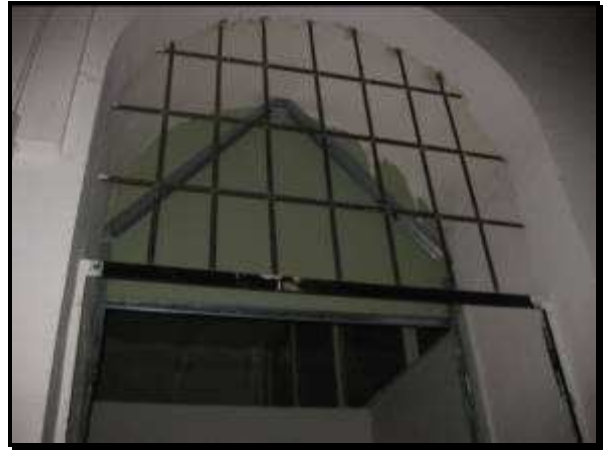
Foto 8 – Zona 1 - Particolare infisso
